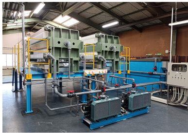
フィルタープレス (全量ろ過排水処理装置)
